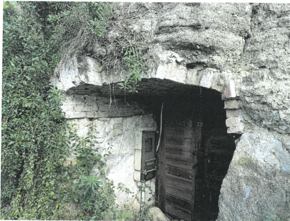
13. kép – Pincesor utca (231/1; 231/2 hrsz.) pince bejárat körüli károsodás, boltív omlás
