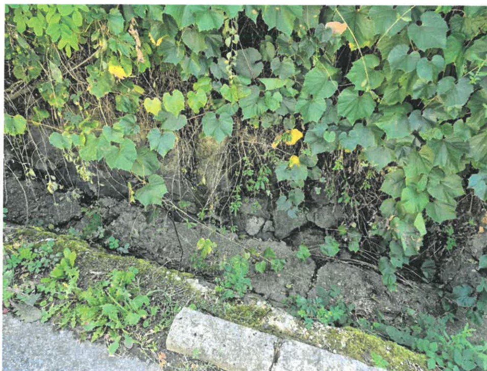
16. kép – Kiss Ernő utca (314/1 hrsz.) árokburkolat károsodása
