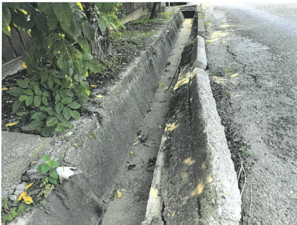
18. kép – Kiss Ernő utca (314/1 hrsz.) árokburkolat károsodása
