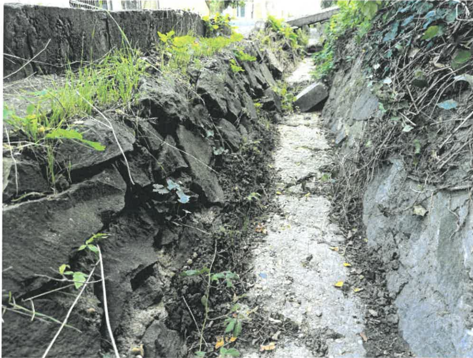
17. kép – Kiss Ernő utca (314/1 hrsz.) árokburkolat károsodása
