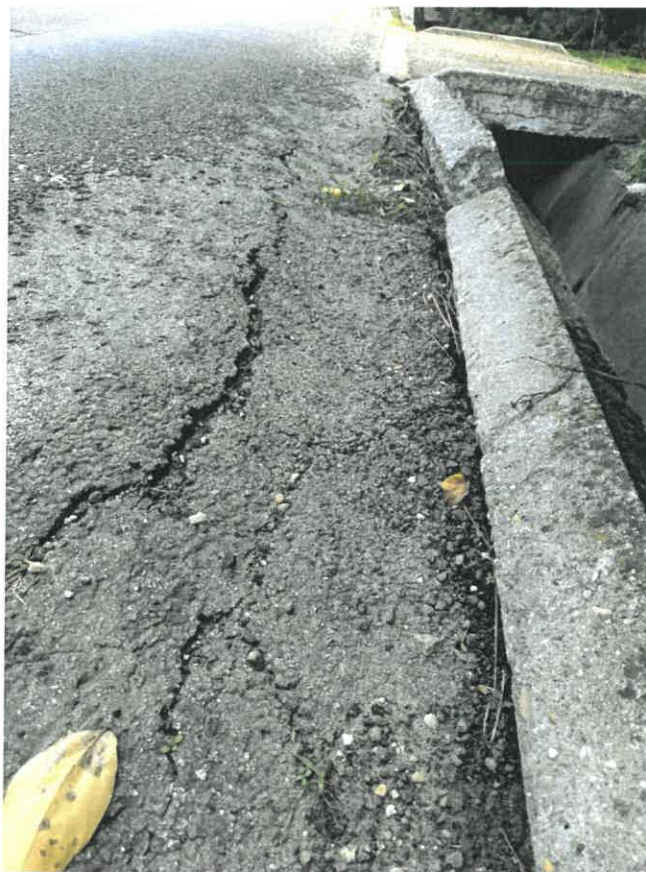
20. kép – Kiss Ernő utca (314/1 hrsz.) útburkolat károsodása
