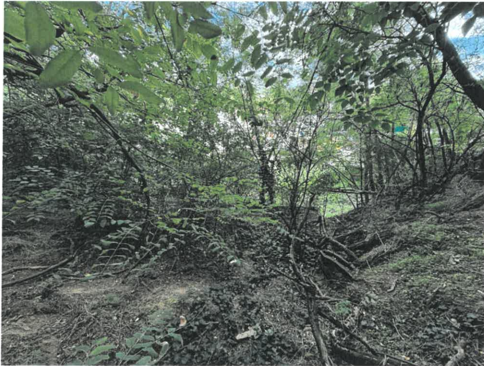
1. kép – Fóti út (1456 hrsz.) a patak-jobboldali partfal károsodása
