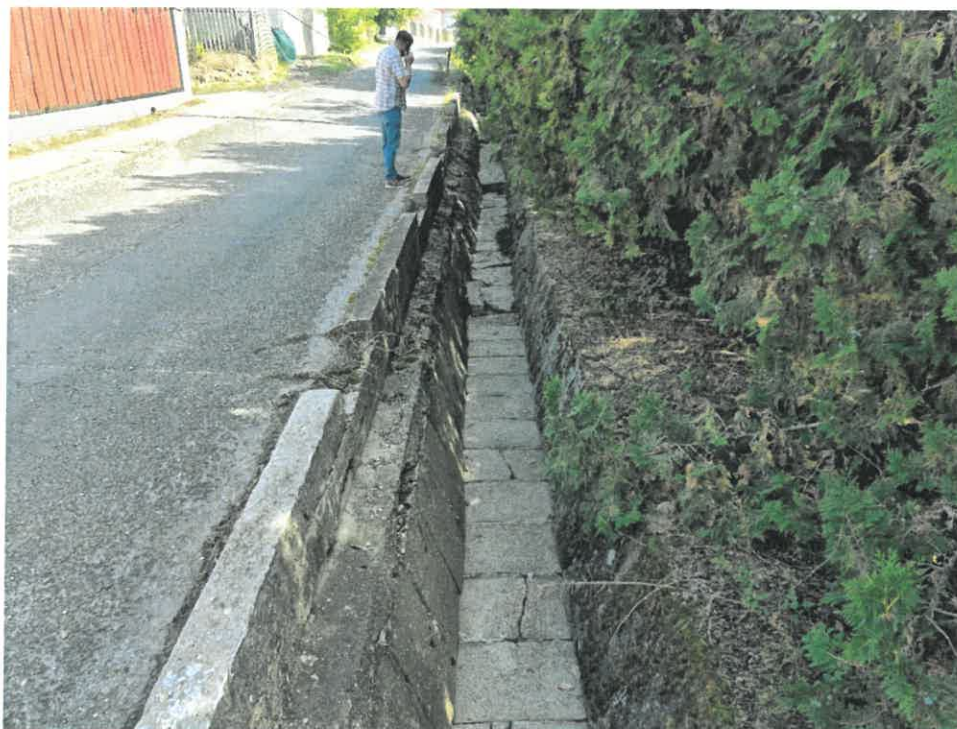
15. kép – Kiss Ernő utca (314/1 hrsz.) árokburkolat károsodása
