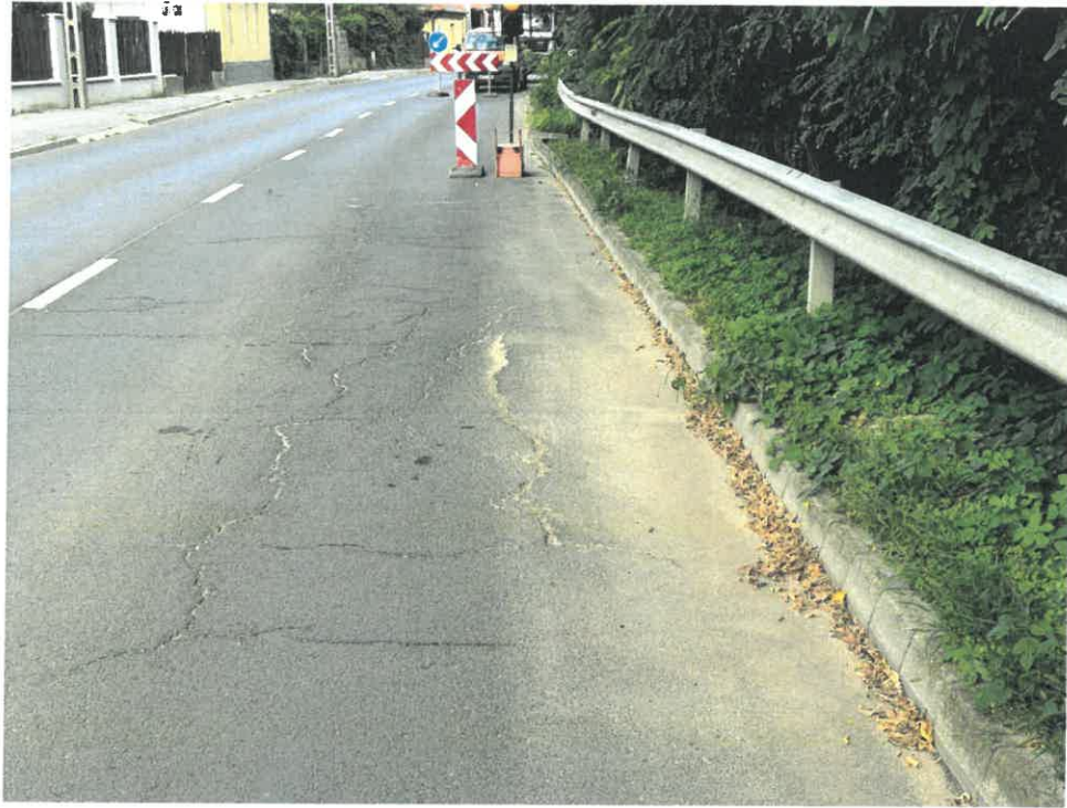
3. kép – Fóti út (1456 hrsz.) repedések az aszfalt burkolatban
