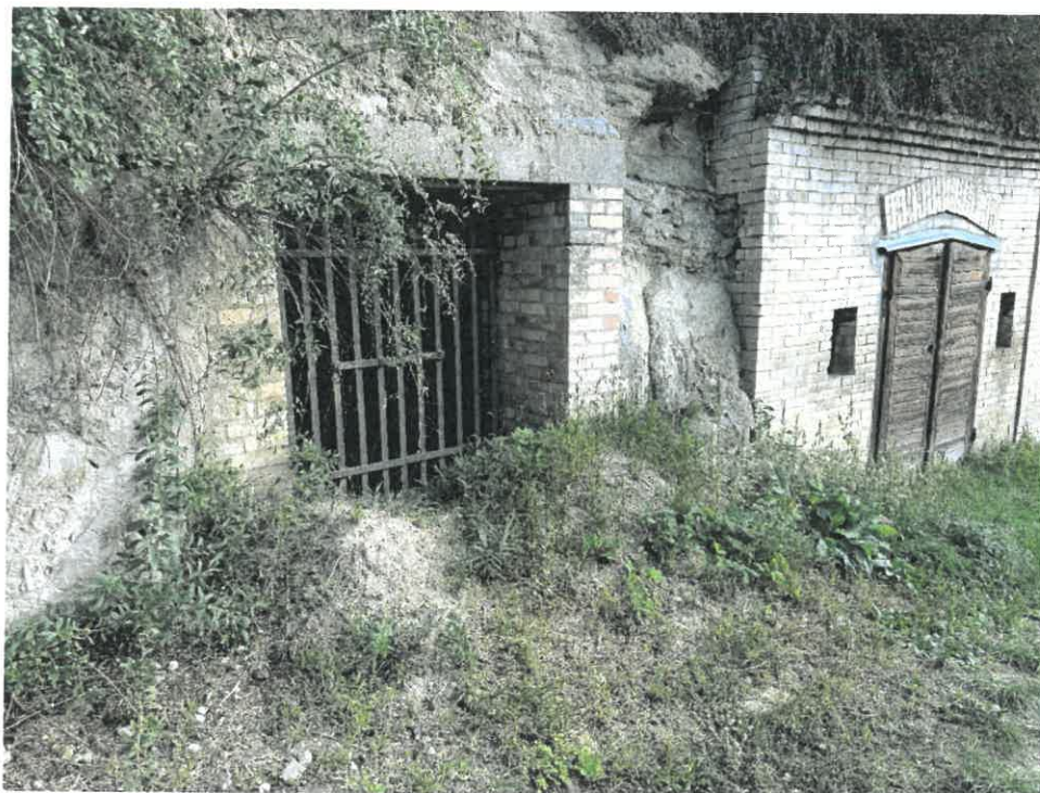
14. kép – Pincesor utca (231/1; 231/2 hrsz.) pince bejárat körüli károsodások
