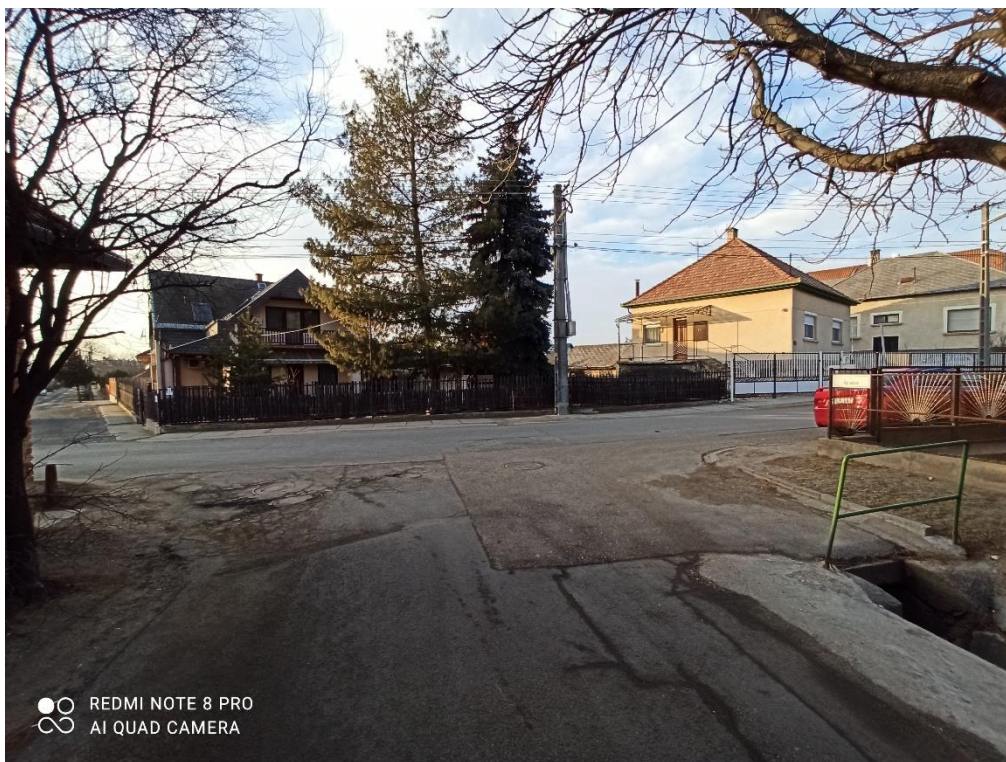
5. kép – Bocskai utcai csatlakozás, széttöredezett, megsüllyedt burkolat
