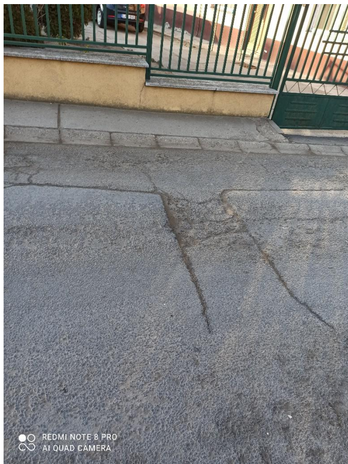
3. kép – széttört, megsüllyedt burkolat
