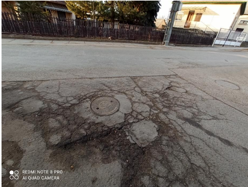
1. kép – mozaikosan széttört útburkolat
