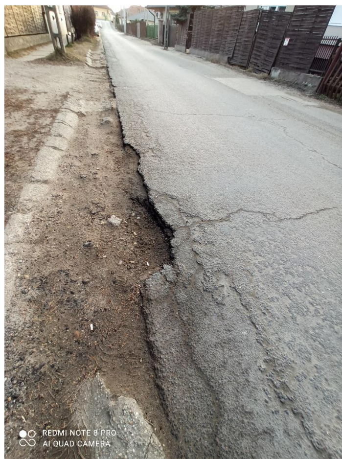
6. kép – erodált útfelület, letört, megsüllyedt burkolatszél
