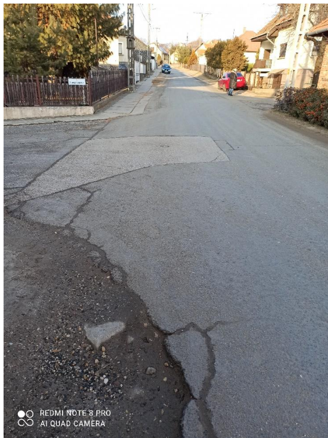
4. kép – Somogyi Béla utcai csatlakozás, letört útszél, korábbi kátyúzás
