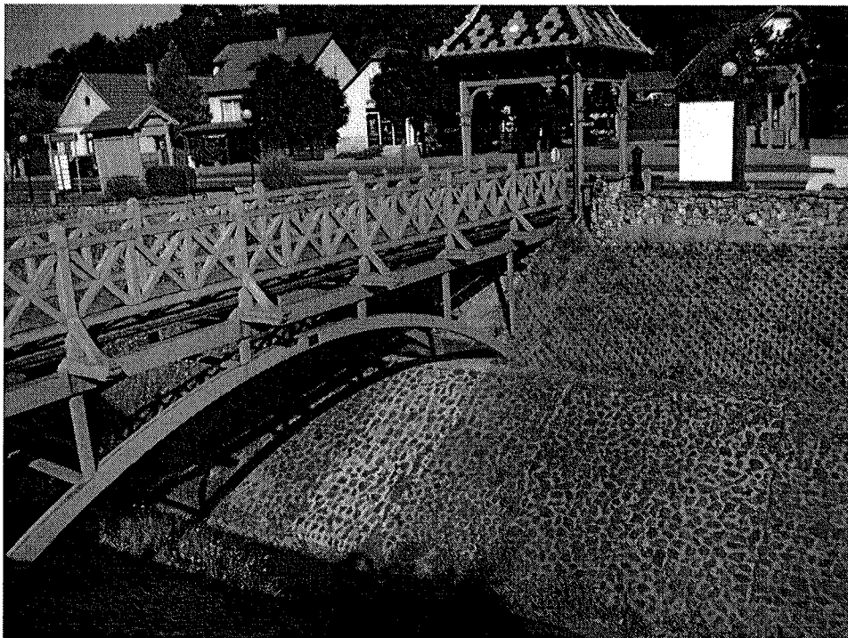
6. kép: A híd jobbparti hídfőlénél is koncentráltan folyt be a víz, mivel a terméskő biztonsági térfal itt lett megszakítva. A gyeprács burkolat a híd alatti 5 m-es szakaszon megsemmisült.
